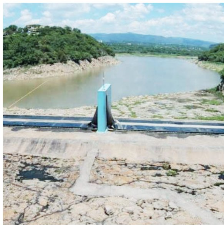
Los Laureles ya está al borde del colapso.
