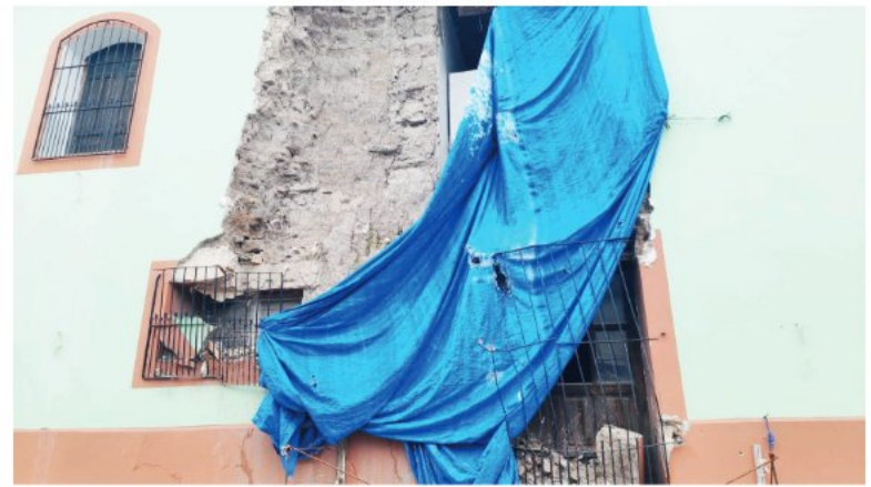
Un segmento de las paredes comenzó a ceder y ha sido protegido con plásticos.
