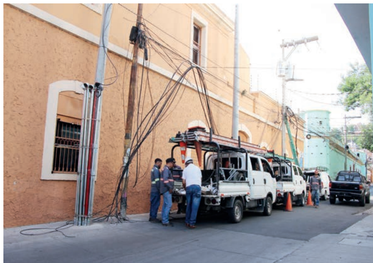
Madejas de cables colgaban de los postes, lo que causaba contaminación visual.
