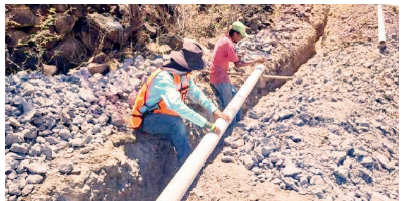
La red primaria del sistema de agua potables es de 22 kilómetros de distancia.
