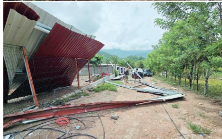
Los vientos huracanados se han vuelto frecuentes en Santa Bárbara, causando destrozos en algunas zonas.
