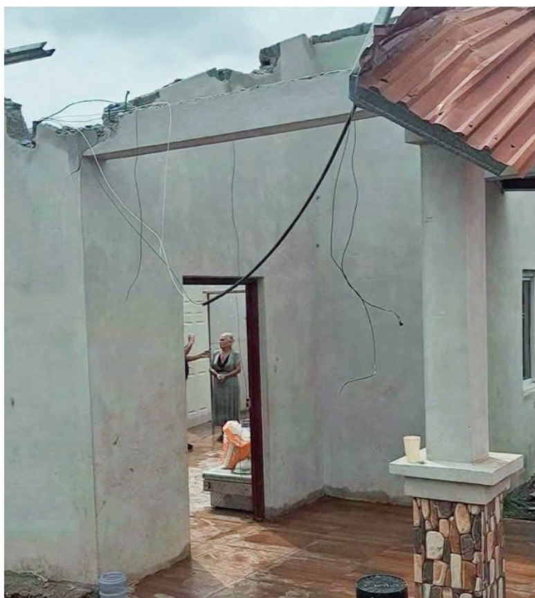
Desprotegidos ante las lluvias y la delincuencia quedaron vecinos en Ceibita.
