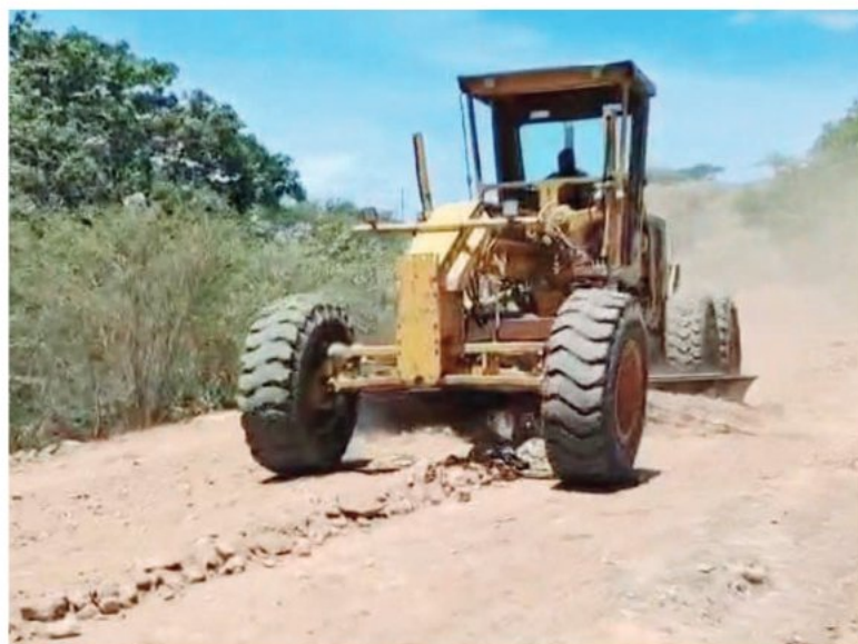
La carretera en esa zona se encuentra en pésimas condiciones.
