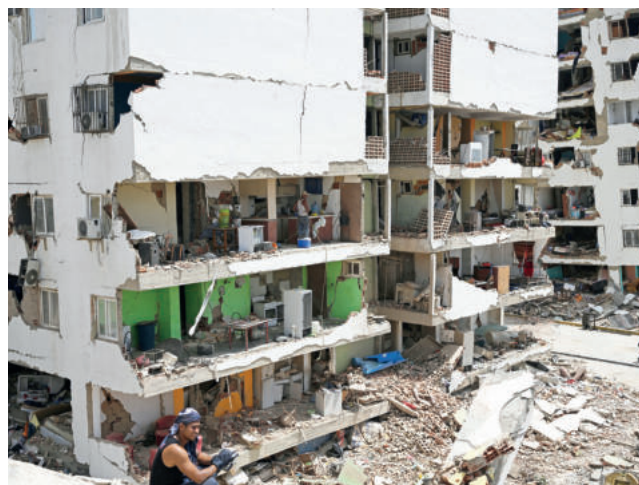
Una imagen muestra edificios de apartamentos gravemente dañados con interiores expuestos entre los escombros en Catia La Mar, La Guaira.
