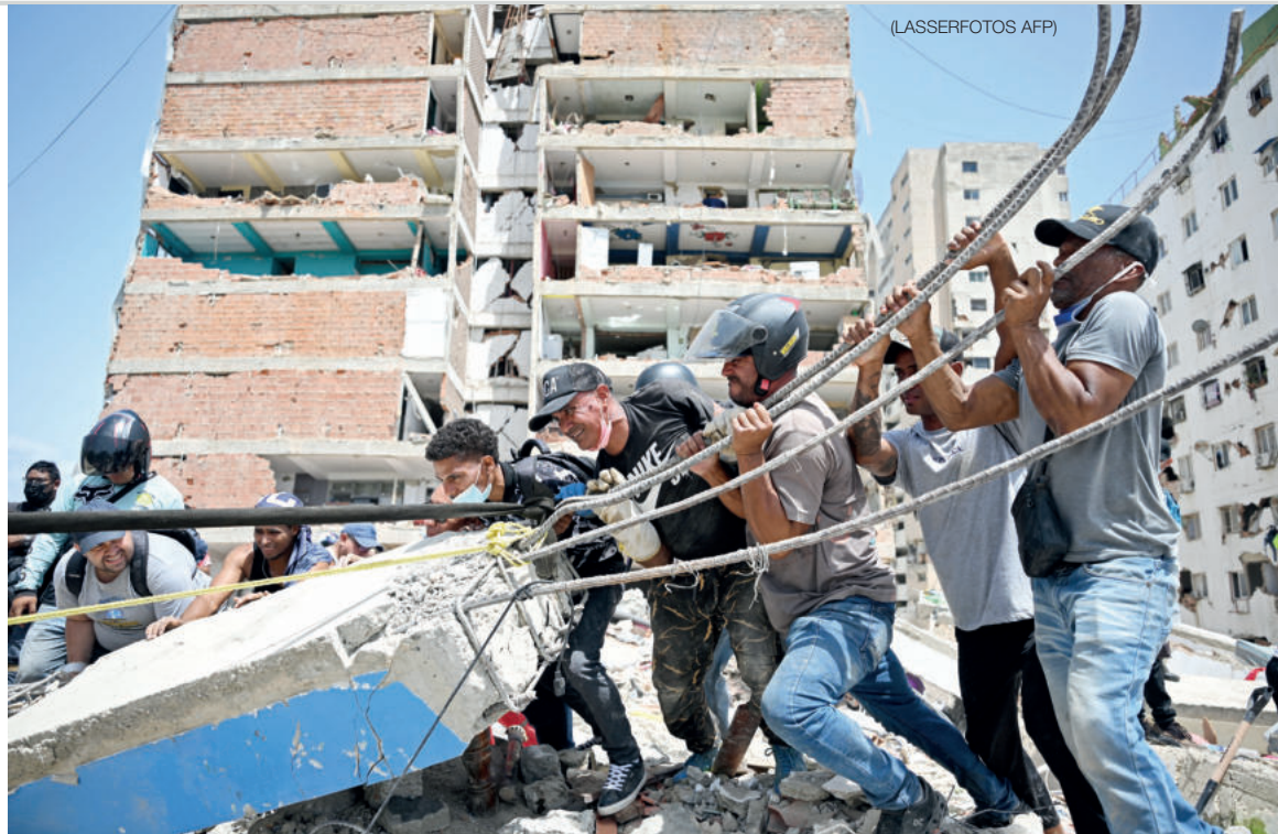
Equipos de rescate, voluntarios y residentes se congregan entre los escombros de los edificios derrumbados durante las operaciones de búsqueda y recuperación en Catia La Mar, La Guaira.
