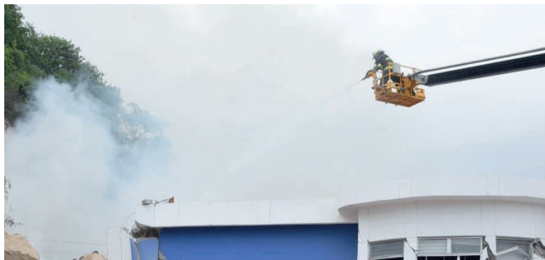
Una grúa de los bomberos fue de gran ayuda en esta emergencia.
