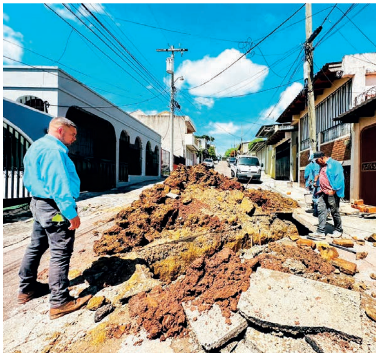
Las colonias con mayor cantidad de desechos en el alcantarillado son la Kennedy, Miraflores, Concepción, entre otras.
