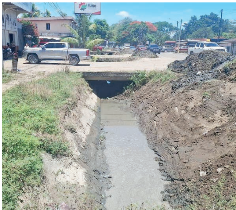
La limpieza oportuna de las cunetas busca evitar inundaciones en el invierno.
