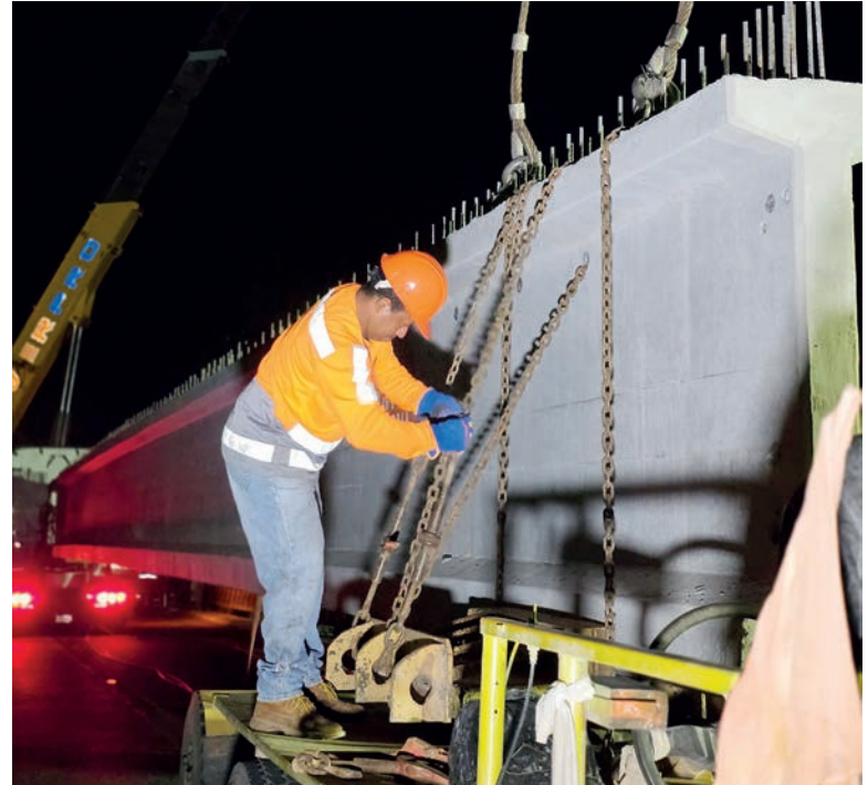
Las vigas fueron trasladadas desde el plantel de CONHSA-PAYHSA hasta Tegucigalpa en un operativo logístico clave.
