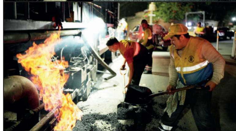
Para prolongar la vida útil de la vía, la intervención se ejecuta mediante una tecnología especializada.
