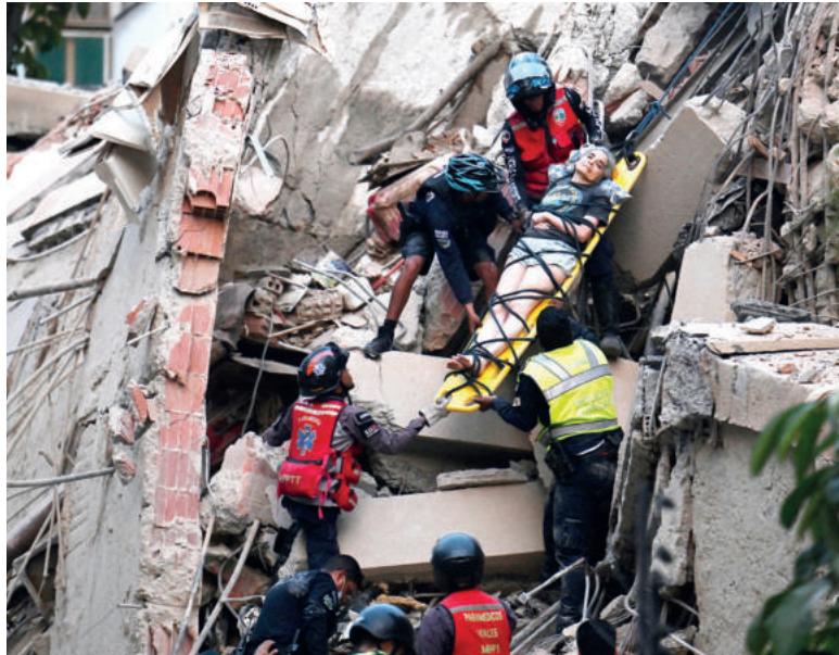
Los rescatistas sacan a una persona en camilla de un edificio derrumbado tras el terremoto que sacudió Caracas.
