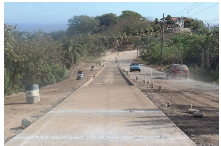
Las obras en ejecución forman parte de un plan integral de modernización de la infraestructura vial.
