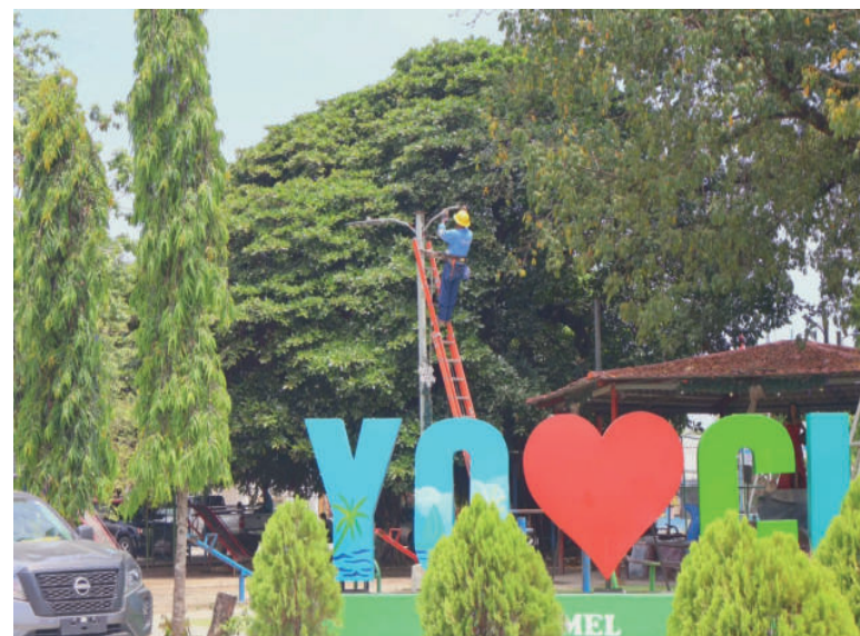
Los empleados de la ENEE trabajan en la aldea en el mejoramiento de la iluminación.
