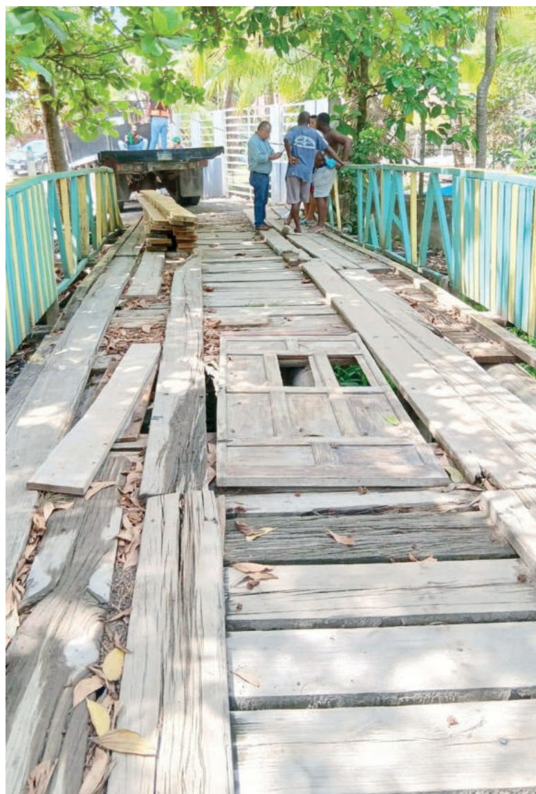
El puente se encuentra intransitable para las personas, mucho menos para vehículos.
