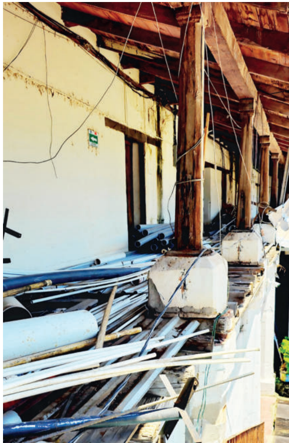
Los antiguos corredores y oficinas están destruidos y son utilizados para almacenar desperdicios de tuberías.
