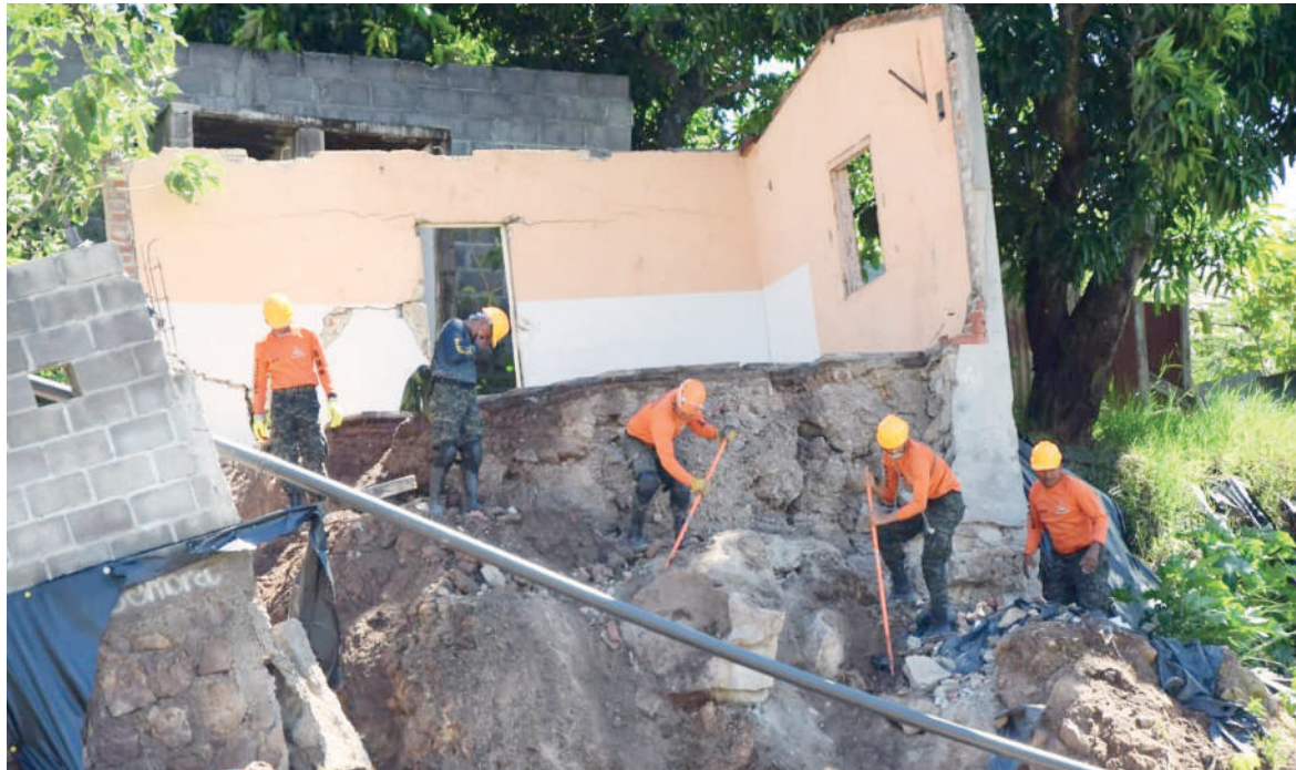
A través de la Unidad Humanitaria y de Rescate (UHR), ayer se seguía removiendo escombros que mantienen en riesgo a varios habitantes de la denominada “Zona Cero”.
